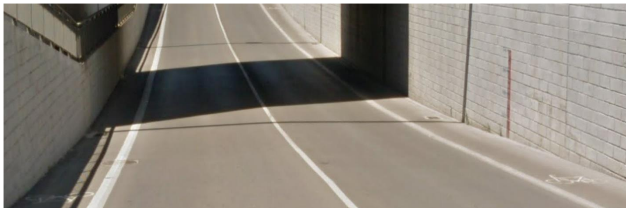
Ilustración 211. Carril bici no seguro en túnel Av. Pío XII, que cruza con la N-340. Necesidad de segregación física entre modos de transporte. Fuente: Elaboración propia.
