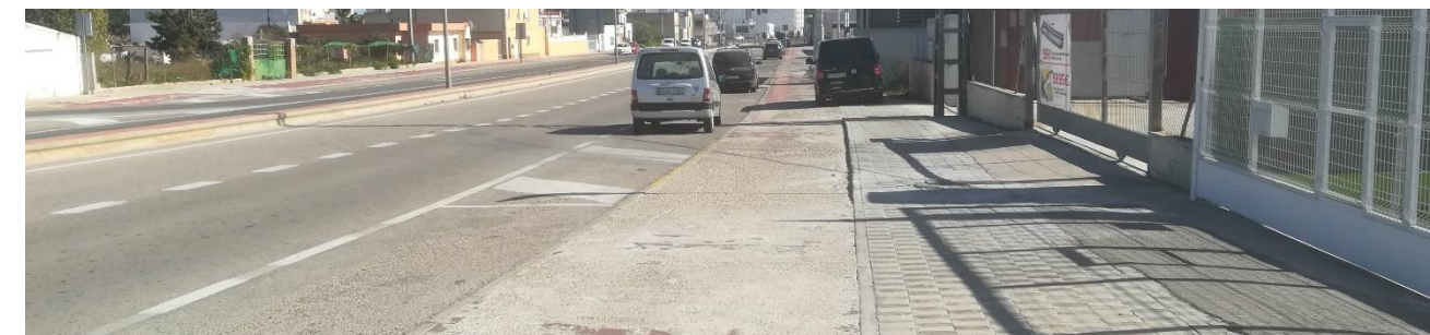
Ilustración 209. Carril bici en mal estado en N-232. Fuente: Elaboración propia
